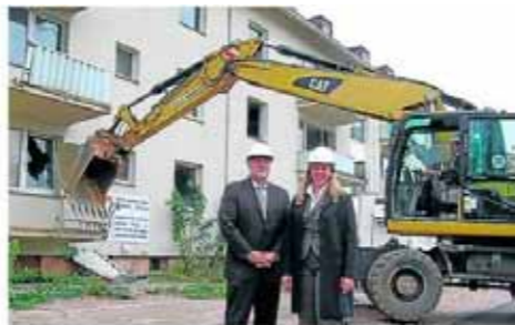
Die ersten Balkongeländer sind gefallen: Bauwert-Geschäftsführer Uwe Birk steuerte selbst den Bagger, zur Überraschung von Jürgen Katz von der BKEG und Oberbürgermeisterin Heike Kaster-Meurer. Foto: Silke Jungbluth-Sepp
